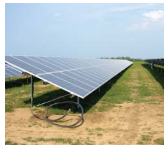
Schließlich müssen Module und Wechselrichter über Kabel noch vernetzt werden.
