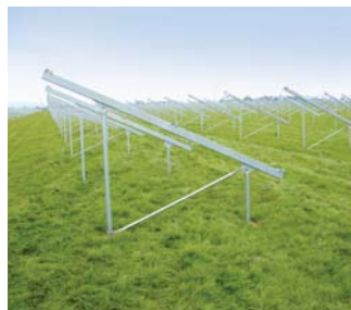
Nachdem die Kabel in der Erde verlegt sind, können die Gestelle aufgeschraubt ...
