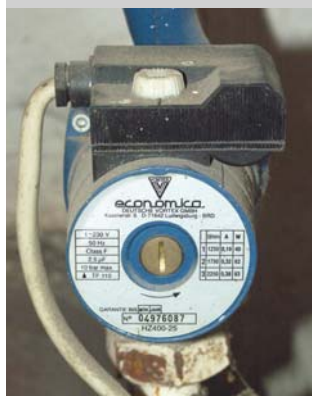
Diese Heizungsanlage ist 25 Jahre alt: jetzt wird es aber Zeit!
