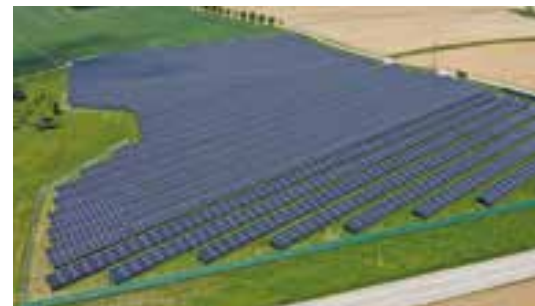
Strom aus dem PV-Park in Karwill wird in Kooperation mit der BürgerEnergie Niederbayern von den Stadtwerken direkt vermarktet.
